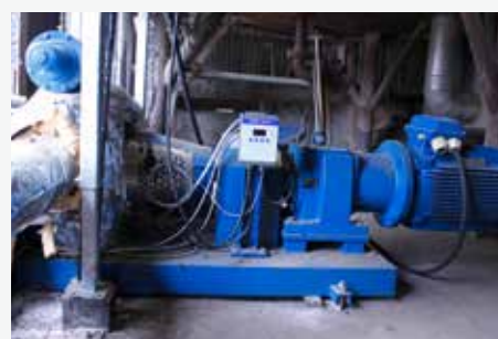
ROTAN® HD152EDDKLT-1U22S installeret på NCC's anlæg i Roust
