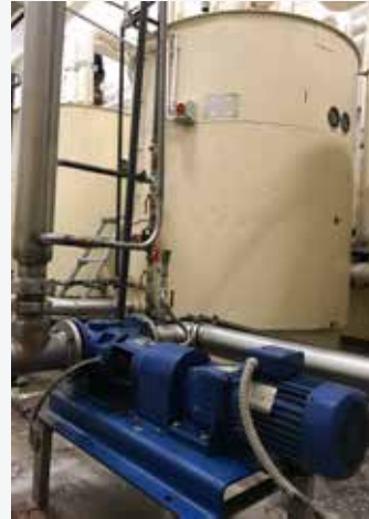
Jedna z pomp zębatych DESMI ROTAN® HD (HD66ECHD-1M22B) zainstalowanych w fabryce Carletti w Pruszkowie pod Warszawą.
